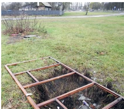
а) размыв грунта по ул. Павлова в г. Гомеле
