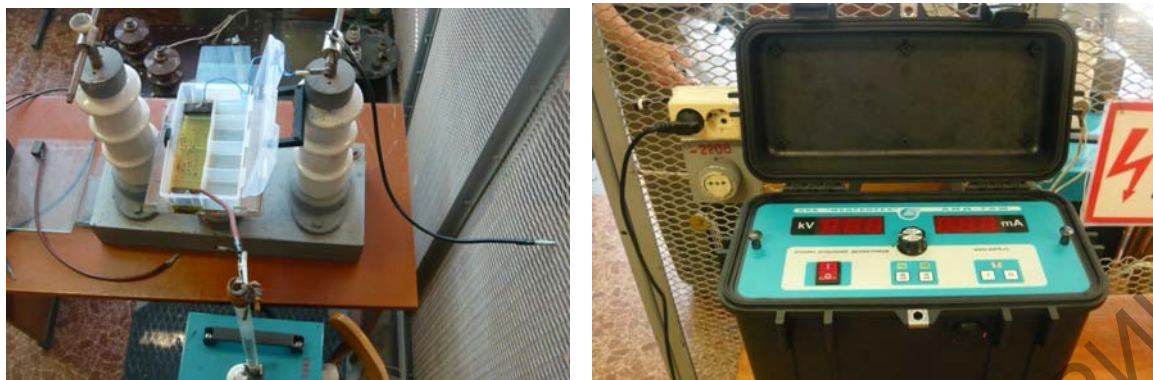
Рис. 1. Высоковольтная испытательная установка АИД-70М
