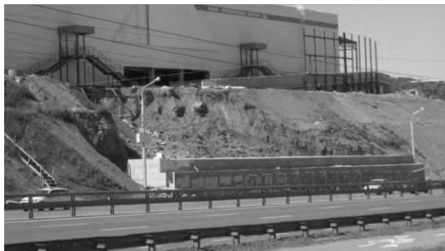
Рисунок 70 - Оползневой цирк и подпорная стенка на участке сошедшего оползня в микрорайоне Сипайлово (фото К.В. Антонова, июль 2014 г.)
