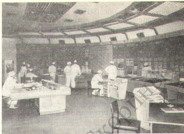
Блочный щит управления
